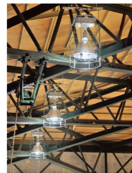
電動昇降装置付高天井用セードはガードも付けて安全性にも配慮している。 The high-ceiling reflector fixture assemblies are fitted with electric elevating devices and guards for safety.
