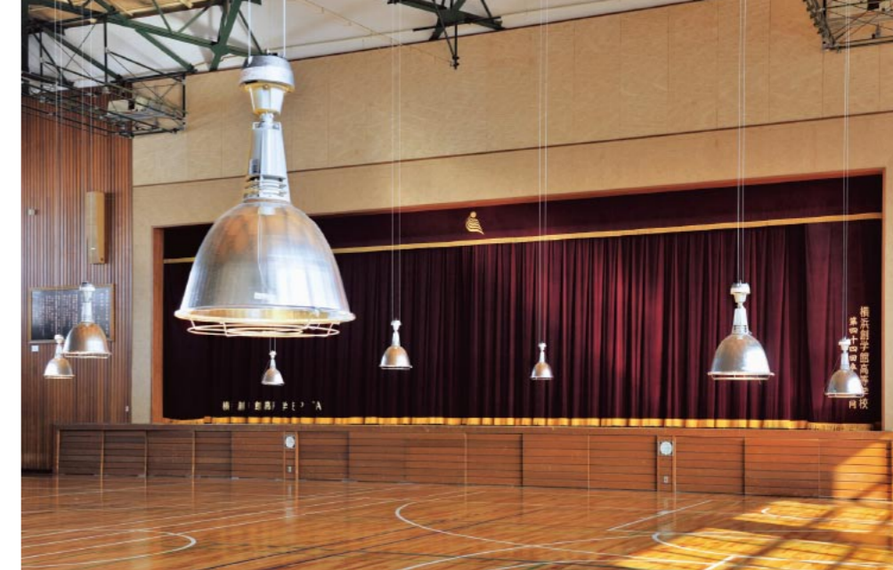
高天井用照明器具は、ランプ交換などのメンテナンス作業を容易に行えるよう電動昇降装置付となっている。 Each reflector fixture assembly is installed with an electric elevating device to make maintenance work, such as changing of the lamps, easy.
